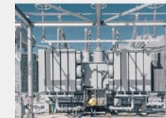
変電所の変圧器
