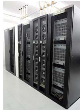
モジュール型データセンタ
