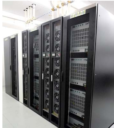
モジュール型データセンタ
