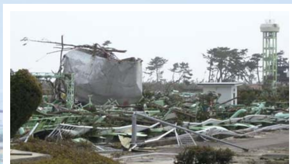
津波の衝撃で瓦礫と化した配管設備。汚水受入施設やポンプ棟、機械・電気設備など多くの施設・設備が破壊された
