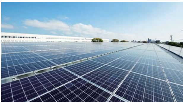
大みか事業所に設置した太陽光発電パネル
