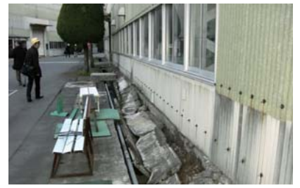
震災直後の日立事業所の建屋。多くの日立グループ工場が大きな被害を受けた
