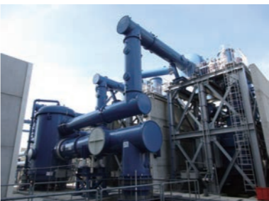
核融合実験装置(上:LHD プラズマ真空容器の内部(写真提供:NIFS)/下:ITER 向け中性粒子ビーム入射装置用電源試験設備)
