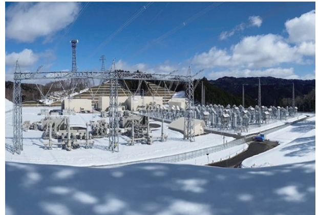
中部電力パワーグリッド飛騨信濃周波数変換設備：日立の高圧直流送電 (HVDC) システムを納入。交流フィルタに日立エナジー製品が採用されている
