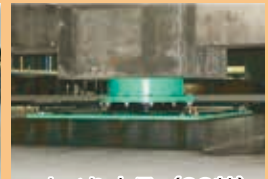
すべり支承 (22基)
