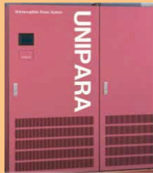
無停電電源装置 (UPS) (100kVA×1台)
