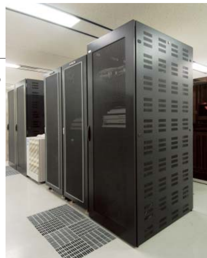
千葉ニュータウン本社に設置されたサーバールーム(ファイルサーバ)
