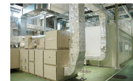
ドライクリーンルーム
