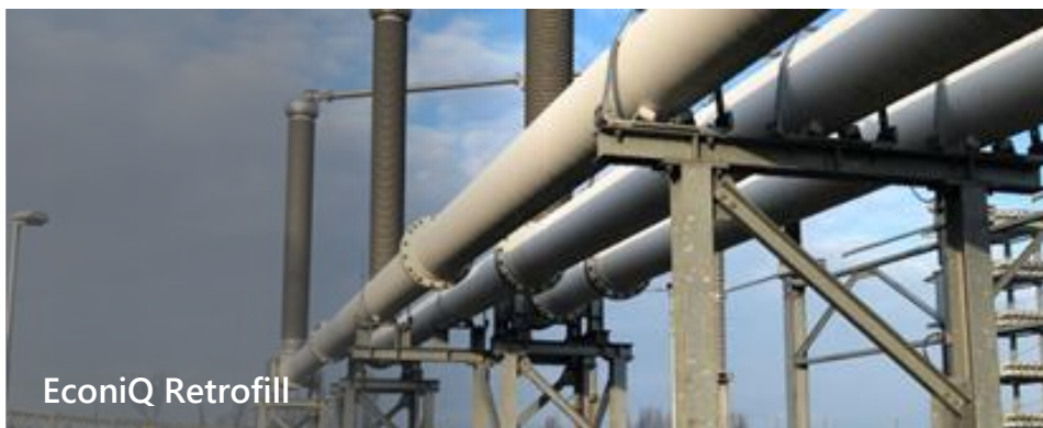
National Grid, UK ELK-3 / 420 kV GI (2016年設置) SF 6 を755 kg 削減
