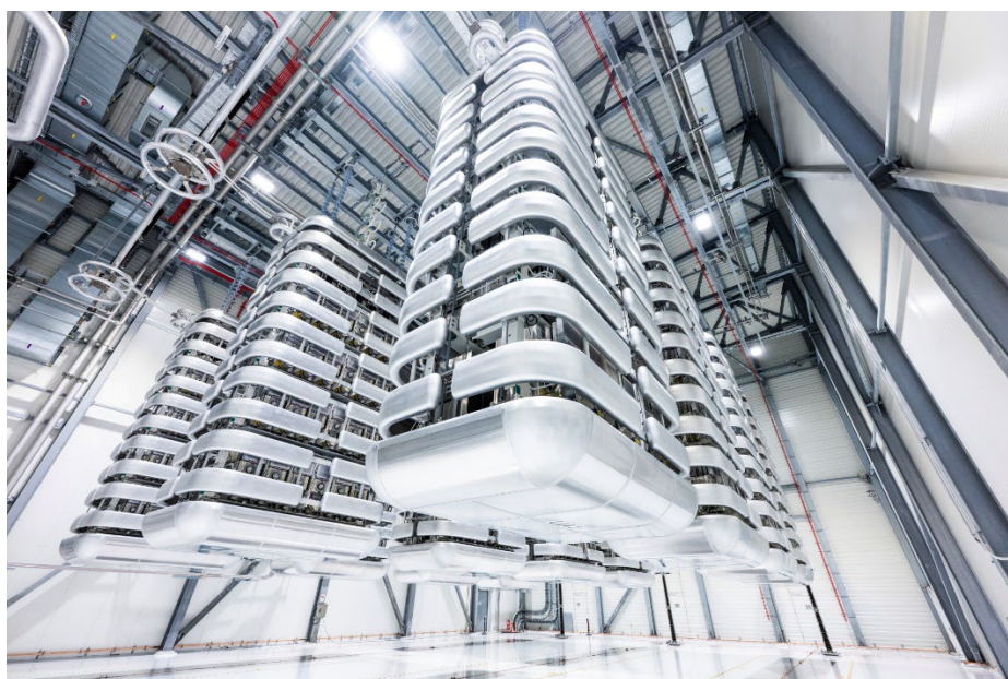
HVDC Light®バルブホール
