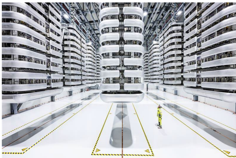
HVDC Light®バルブホール
