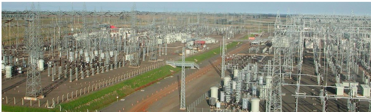
ブラジル・ガラビ HVDC 変換所
