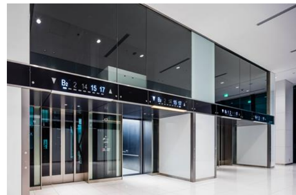
オフィスの高速大容量エレベーター
