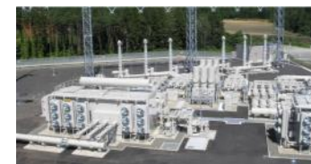
変電所、遮断器、変圧器
