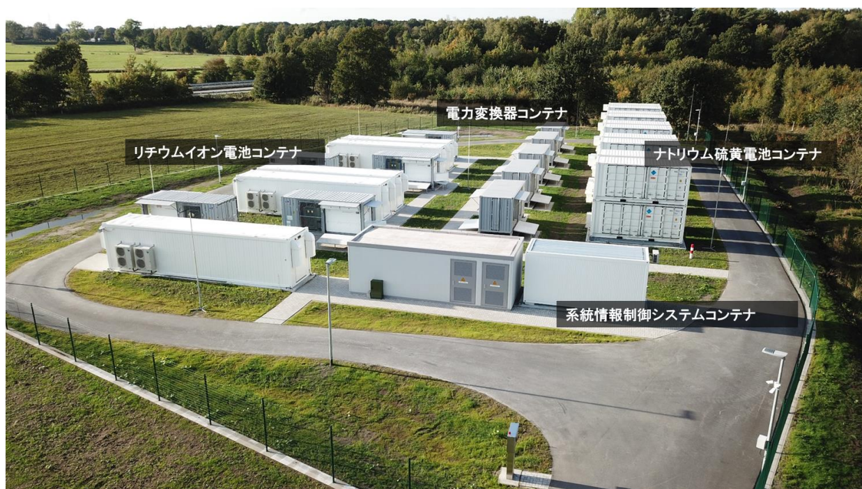
写真 実証運転を開始する大規模ハイブリッド蓄電池システム
