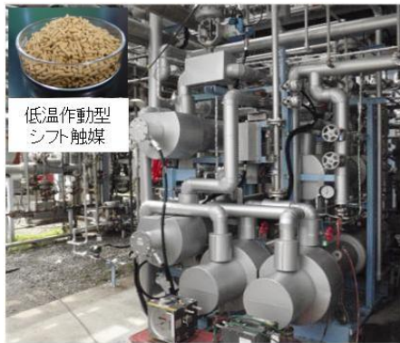
図 1: 石炭ガス化ガス実証設備 および開発触媒
