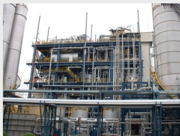
高機能プラスチック製造プラント
