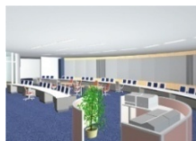
監視制御システム
