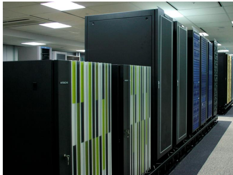
「Harmonious Cloud Square」の検証設備(イメージ)
