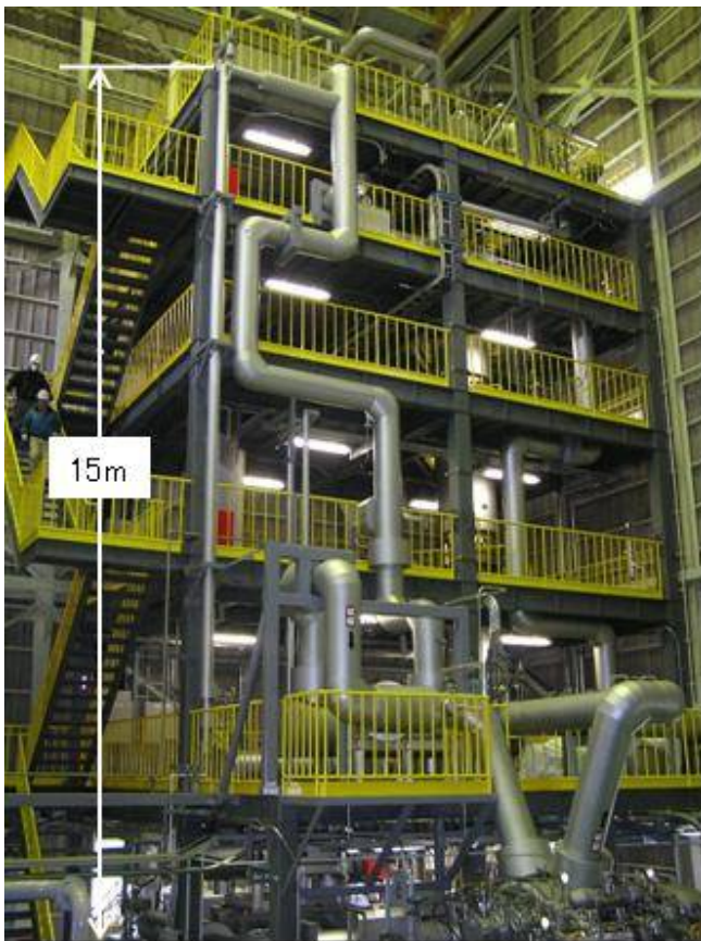
多目的蒸気源試験設備(HUSTLE)の外観
