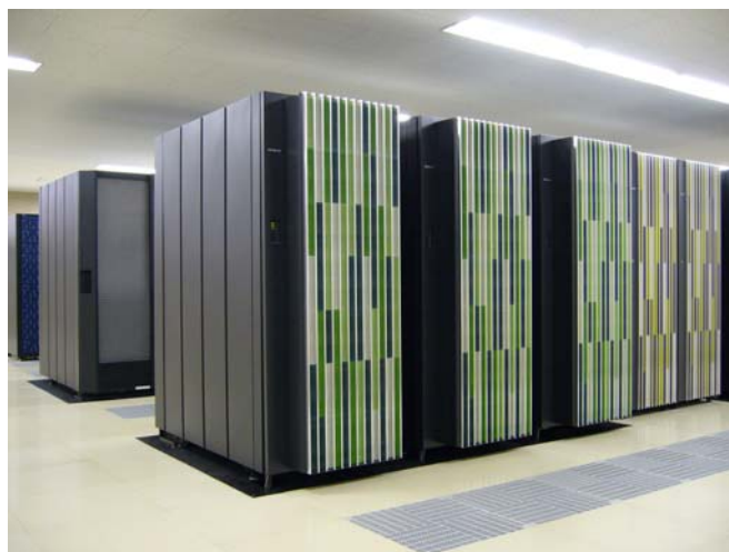
核融合科学研究所 プラズマシミュレータシステム (スーパーテクニカルサーバ「SR16000」)
