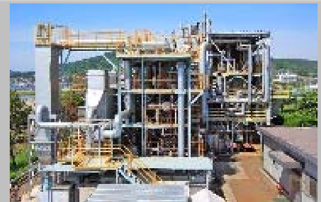
排煙研究設備
