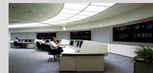
運行・電力管理システム
