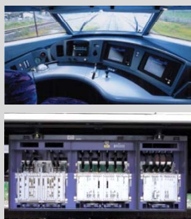
信号・列車制御システム
