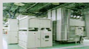
受変電システム
