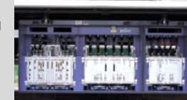
信号・列車制御システム
