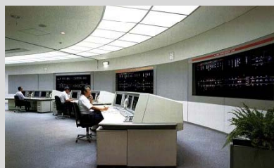
運行・電力管理システム
