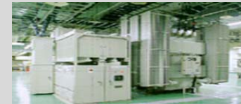
受変電システム
