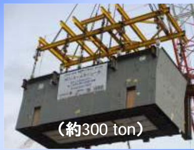
水圧制御ユニット室モジュール
